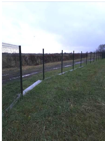
Vol de 11 panneaux de clôture à la station de La Pierre Plate
