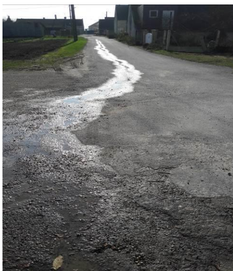
Fuite chemin de la Gardière à Saint Nicolas de Bourgueil
