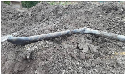
Conduite arrachée au Port Charbonnier Coteaux sur Loire
