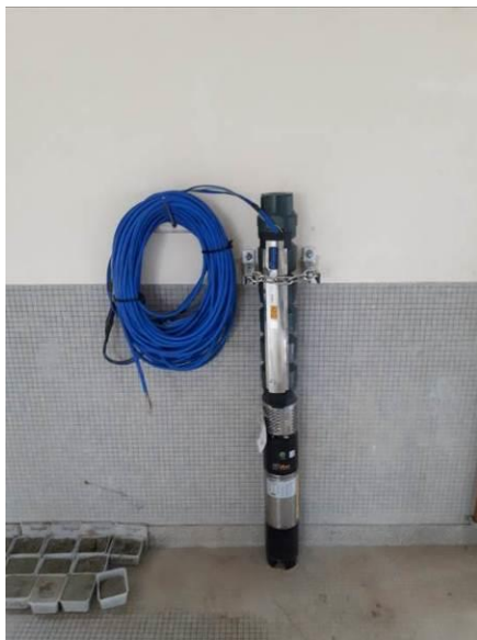
Pompe de secours à la station Les Geslets
