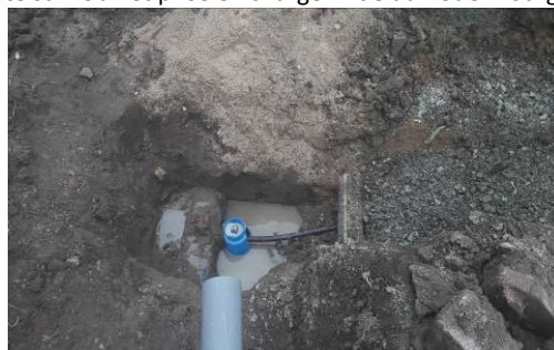
Fuite sur robinet prise en charge 4 rue du Bouef Bourgueil
