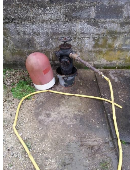
Prise d'eau illicite rue du Port Plat Coteaux sur Loire
